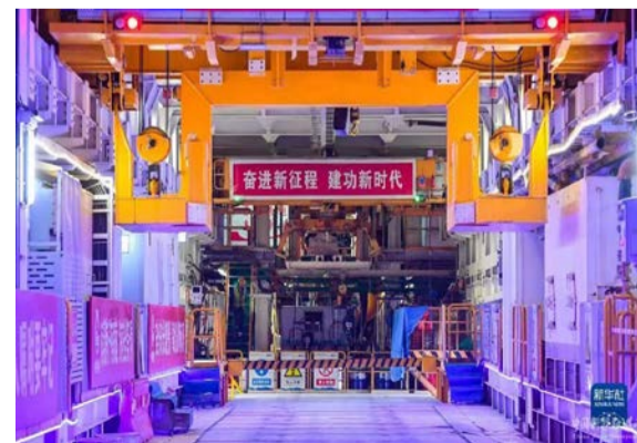
这是在深江铁路珠江口隧道广州南沙段拍摄的中铁隧道局“大湾区号”盾构机（4月10日摄）。新华社记者 刘大伟 摄
