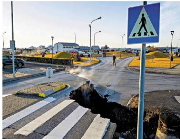
图：冰岛格林达维克镇马路上13日出现巨大裂缝。 \ 法新社
