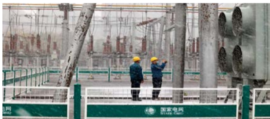
国网寿光市供电公司变电运维人员冒着风雪检查变电站积雪情况。（国网寿光市供电公司供图）
