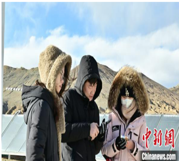
西安建大科研团队正在对太阳能集热场进行故障排查。（西安建筑科技大学供图）
