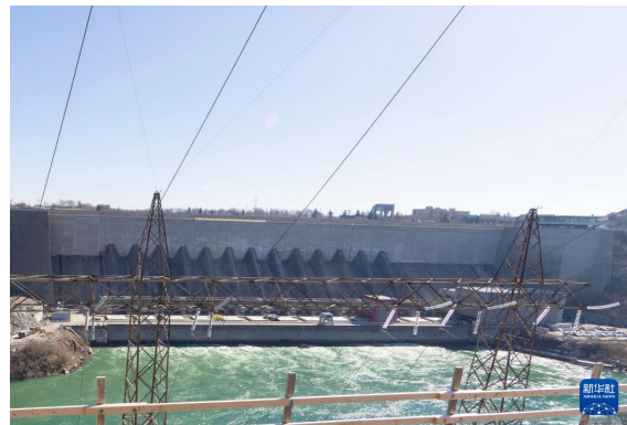
这是 3 月 10 日在加拿大安大略省尼亚加拉瀑布市拍摄的位于加美边境地带的亚当·贝克爵士水电站输电线和美国罗伯特·摩西·尼亚加拉水电站。
